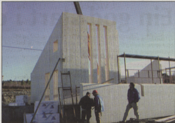
Bilde: Dovrehytta som Holz100 Norge AS har ansvaret for oppsetjinga av. Byggeleder er Heinz Korschniecke. Foto: Aud Einbu.
